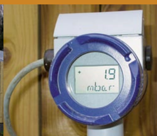
overdrukindicatie in mbar (=gram) op biogasleiding en in biogasopslag. Maximale overdruk bedraagt 3,5 mbar.
