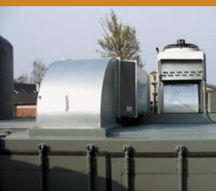
WKK-module: aansluiten luchtkanalen en noodkoeling
