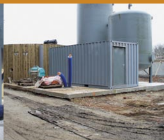
levering opslagtanks voor vloeibare biomassa
